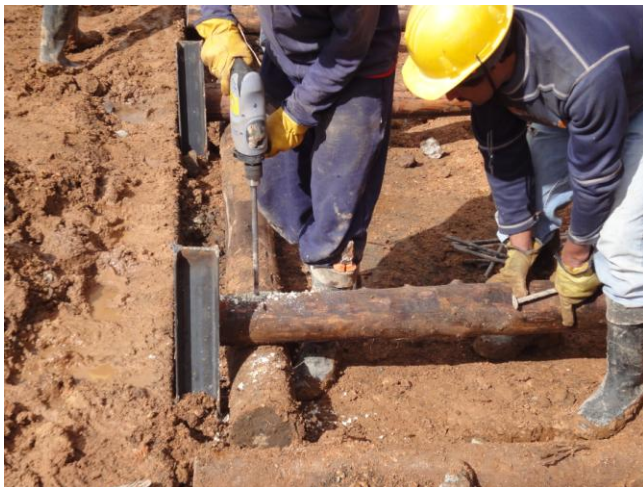
Detalle de la perforación de los postes de madera para la sucesiva colocación de clavos
