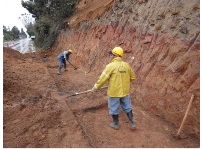
La fase conclusiva de la excavación de la base de la obra
