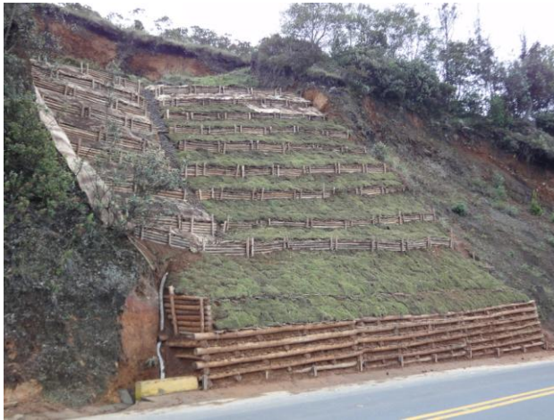
La obra finalizada con las distintas técnicas de consolidación, estabilización, recubrimiento y drenaje.
