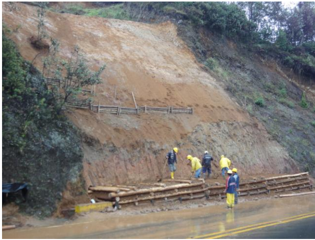
El entramado de madera a la base del talud en la fase intermedia del trabajo.
