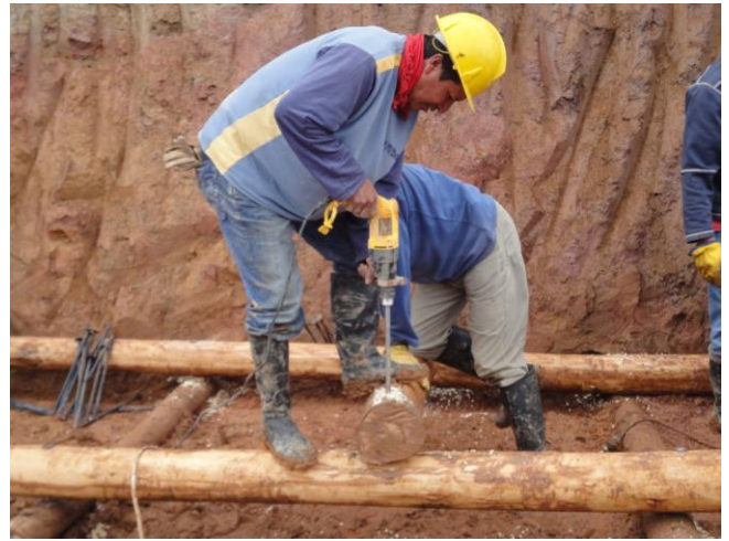
Perforación de los postes de madera para la sucesiva colocación de clavos
