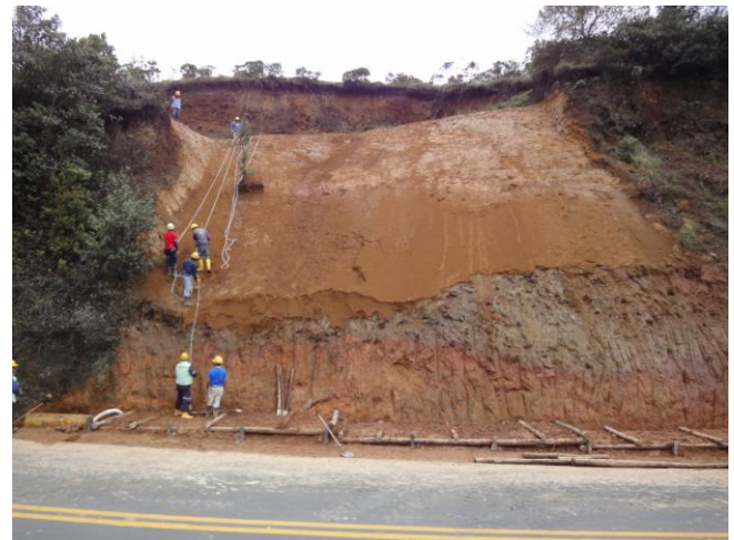
El comienzo de la realización de las empalizadas vivas a lo largo del talud
